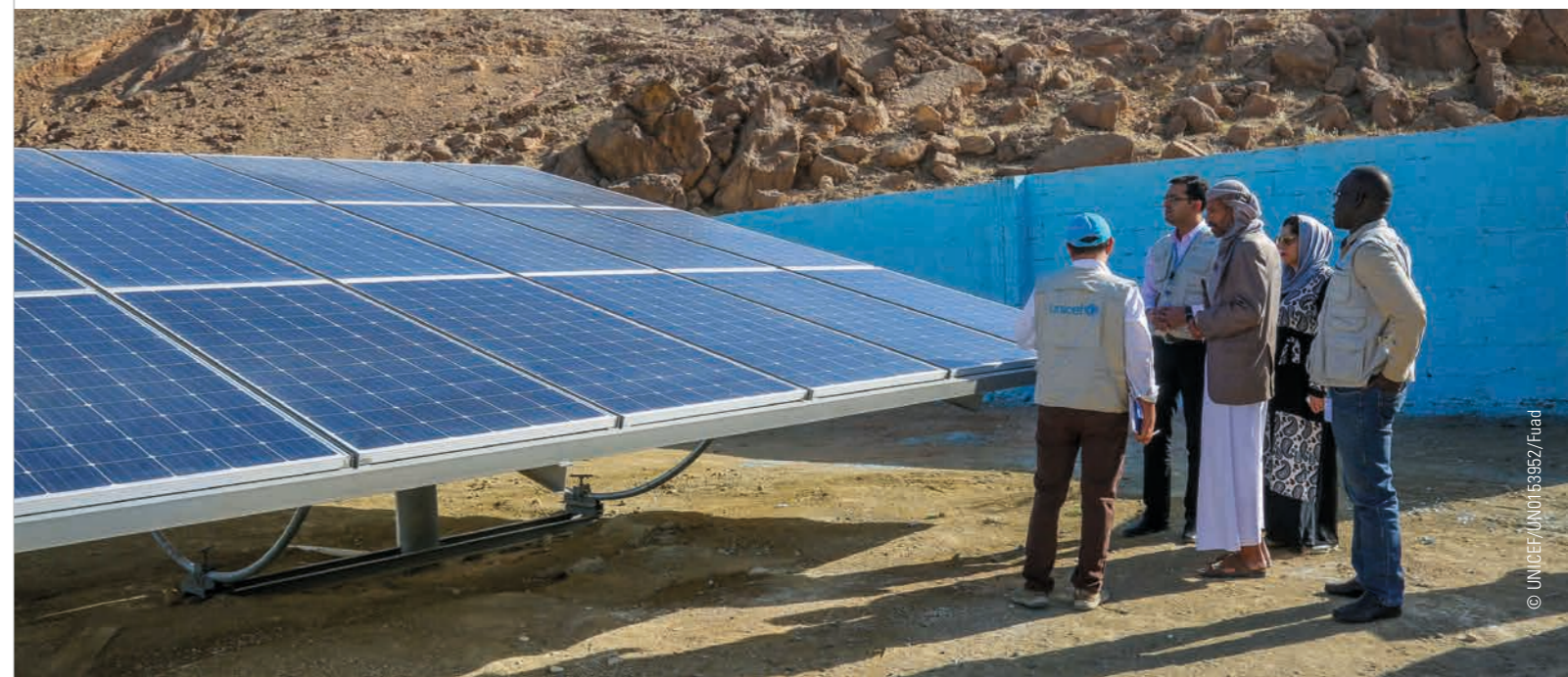
Le personnel de l'UNICEF inspecte un système fonctionnant à l'énergie solaire nouvellement installé à Sa'ada, au Yémen.
